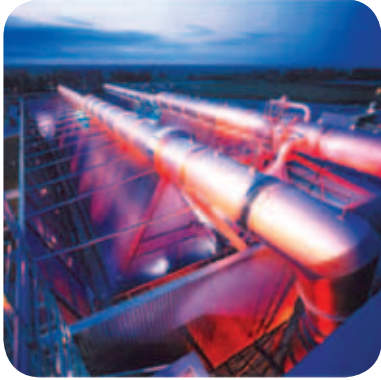
电厂空冷系统
